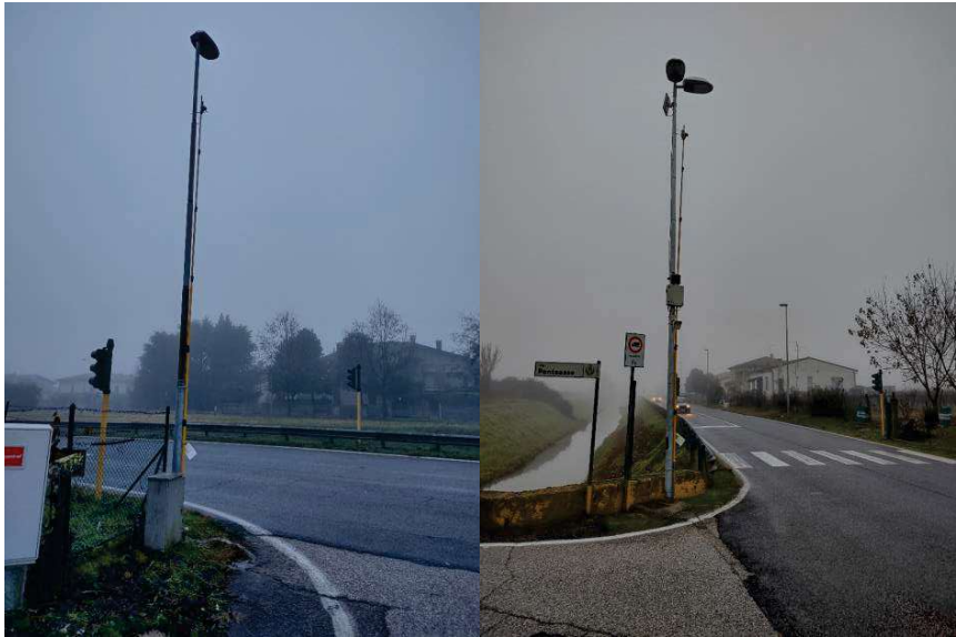
TLC04 – installazione del punto di osservazione A TLC04 – installazione del punto di osservazione B
